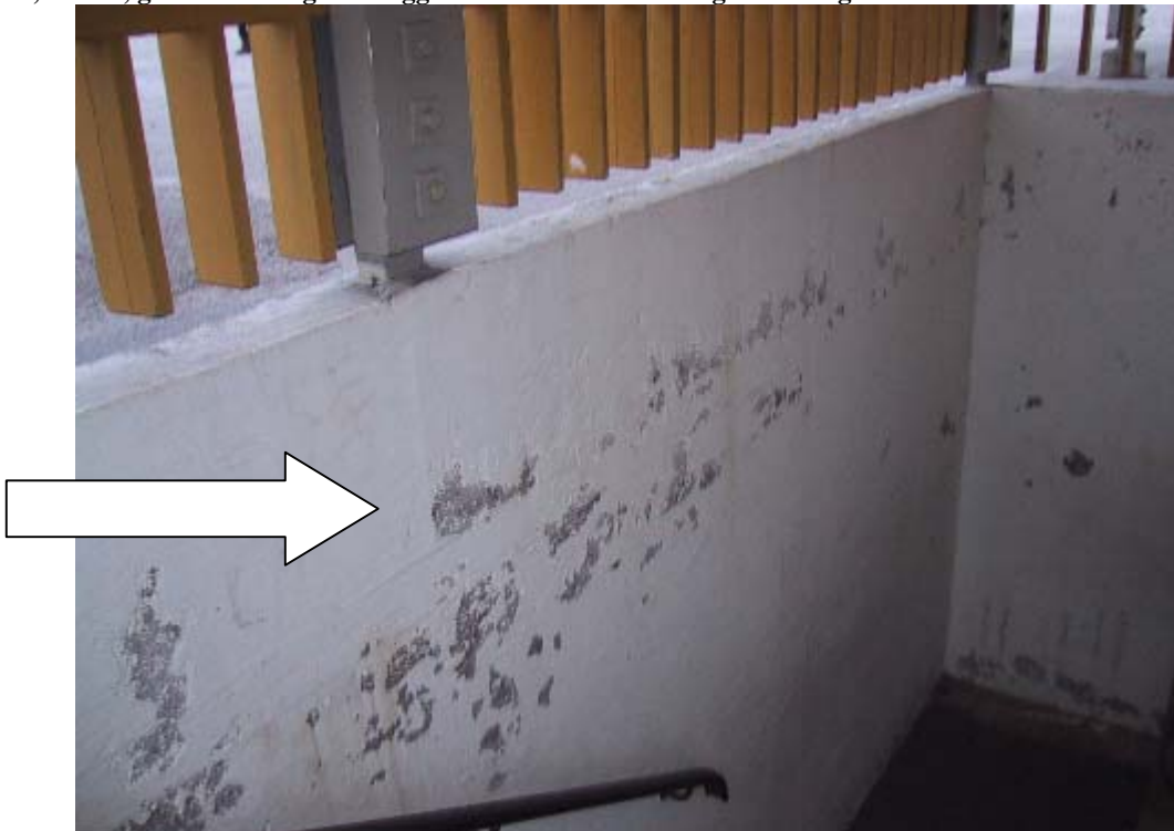
Berg skole, trappenedgang til kjeller. Viser fuktgjennomslag pga. manglende/dårlig drenering.
