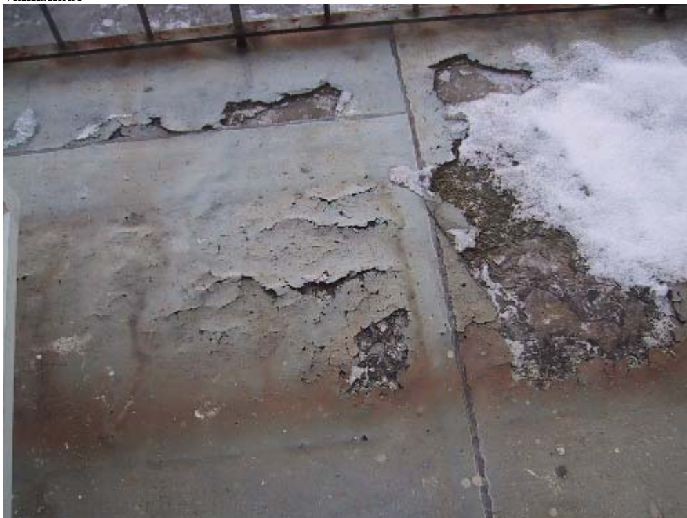
Veranda med vannskade
