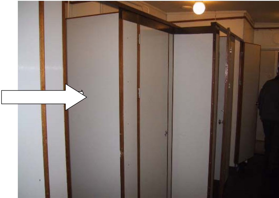
Berg skole, toalett, gutter. V iser spanskvegger som ønsket byttet ut med fast, hele vegger.
