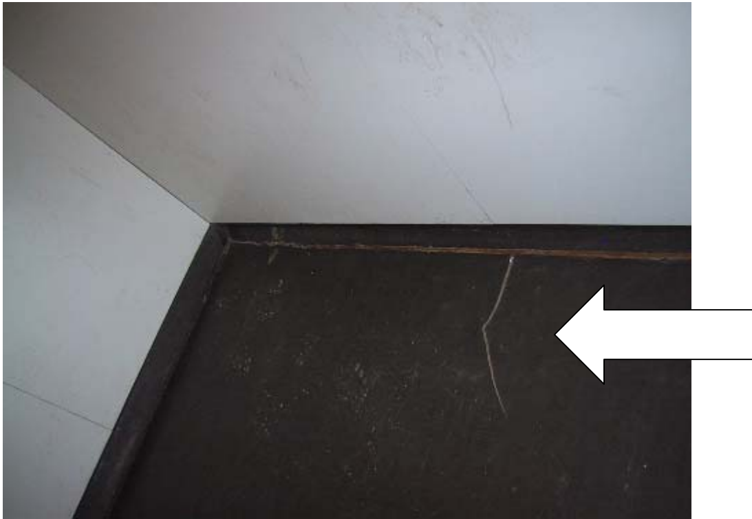
Berg skole, toalett, gutter. Viser gulvbelegg som må skiftes. Viser også svikt i gulv.
